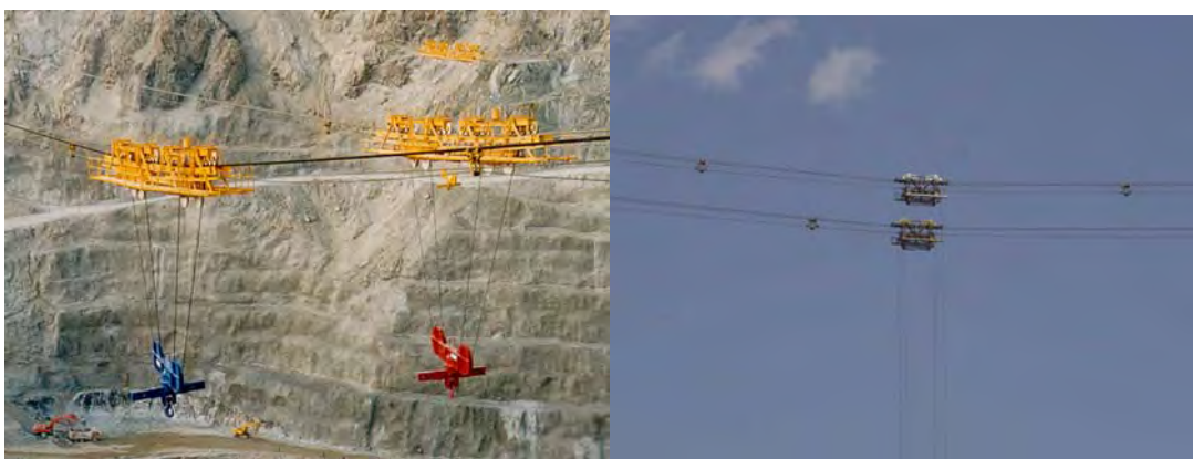
شکل ۶-۶-۹- سیم بکسل‌های جرثقیل کابلی
