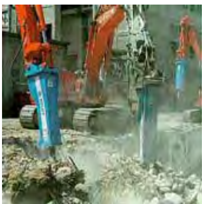
شکل ۳-۱۰-۳- تخریب ساختمانهای قدیمی
