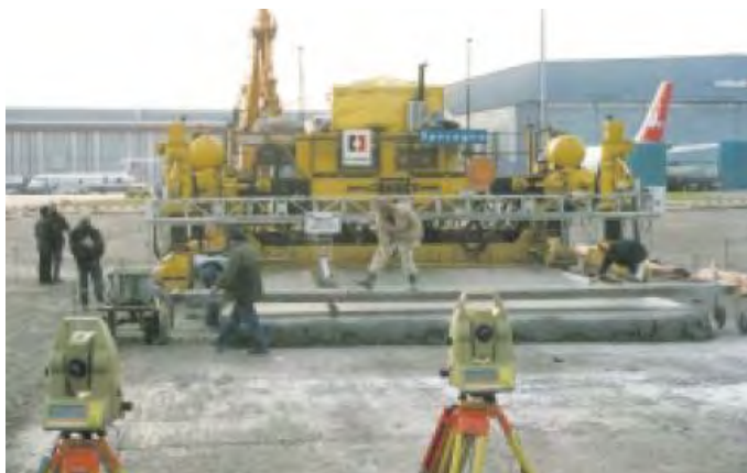
شکل ۲-۱۸-۹- استفاده از سیستم بدون سیم
